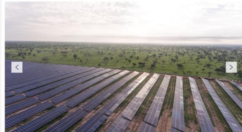
PV- Solaranlage von Senergy PV SA
